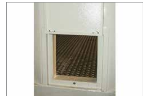
▲ (Opening for) power cables entry Ouverture entrée câbles de puissance
