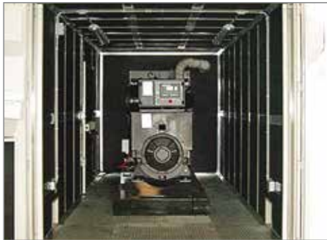
▲ Generating set frontal access door Porte frontale d'accès au groupe électrogène
