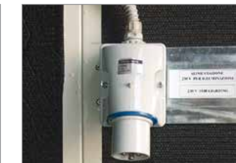
▲ Internal supply point 230V Point d'alimentation intérieure 230V
