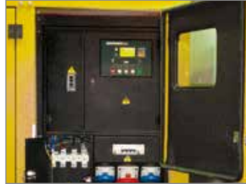
▲ Distribution board with sockets kit and busbar Coffret de distribution avec kit de prises et bornier de puissance
