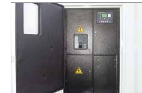
▲ Distribution board mounted on the long side of the generating set Coffret de distribution monté sur côté longue du groupe électrogène
